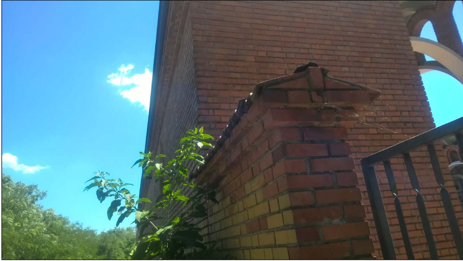
DETT. COPERTINA RECINZIONE ESISTENTE IN MURATURA
