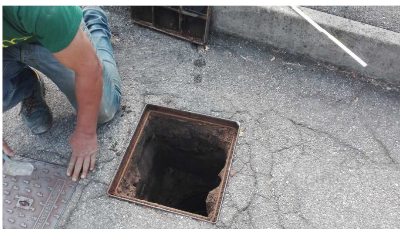
Pozzetto n. 2 del disoleatore esistente
