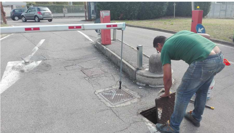
Pozzetto n. 1 del disoleatore esistente
