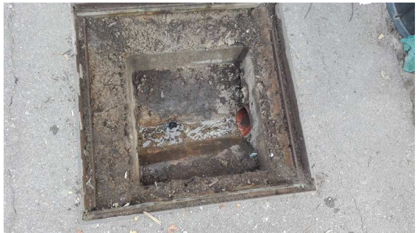
Pozzetto scarico wc guardiola
