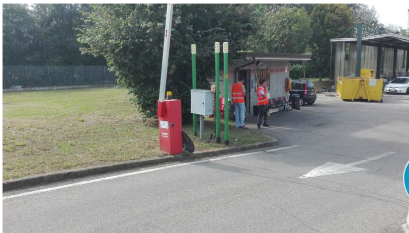
Vista degli sfiati della tubazione gas metano
