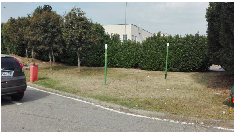
Vista degli sfiati della tubazione gas metano
