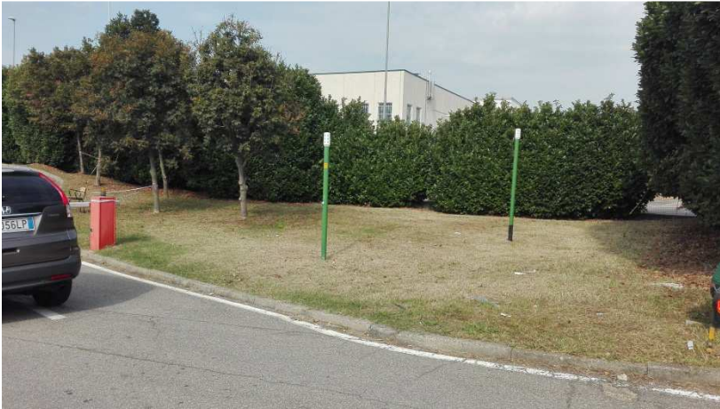
Vista degli sfiati della tubazione gas metano
