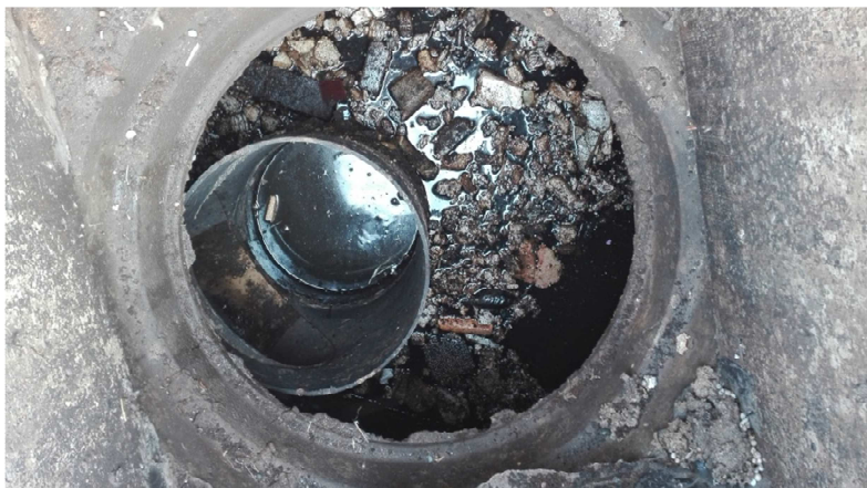
Pozzetto n. 1 del disoleatore esistente
