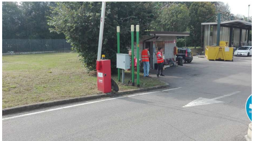
Vista degli sfiati della tubazione gas metano
