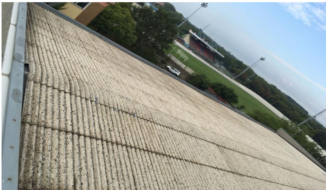
Bocciodromo – veduta tetto cemento amianto.
