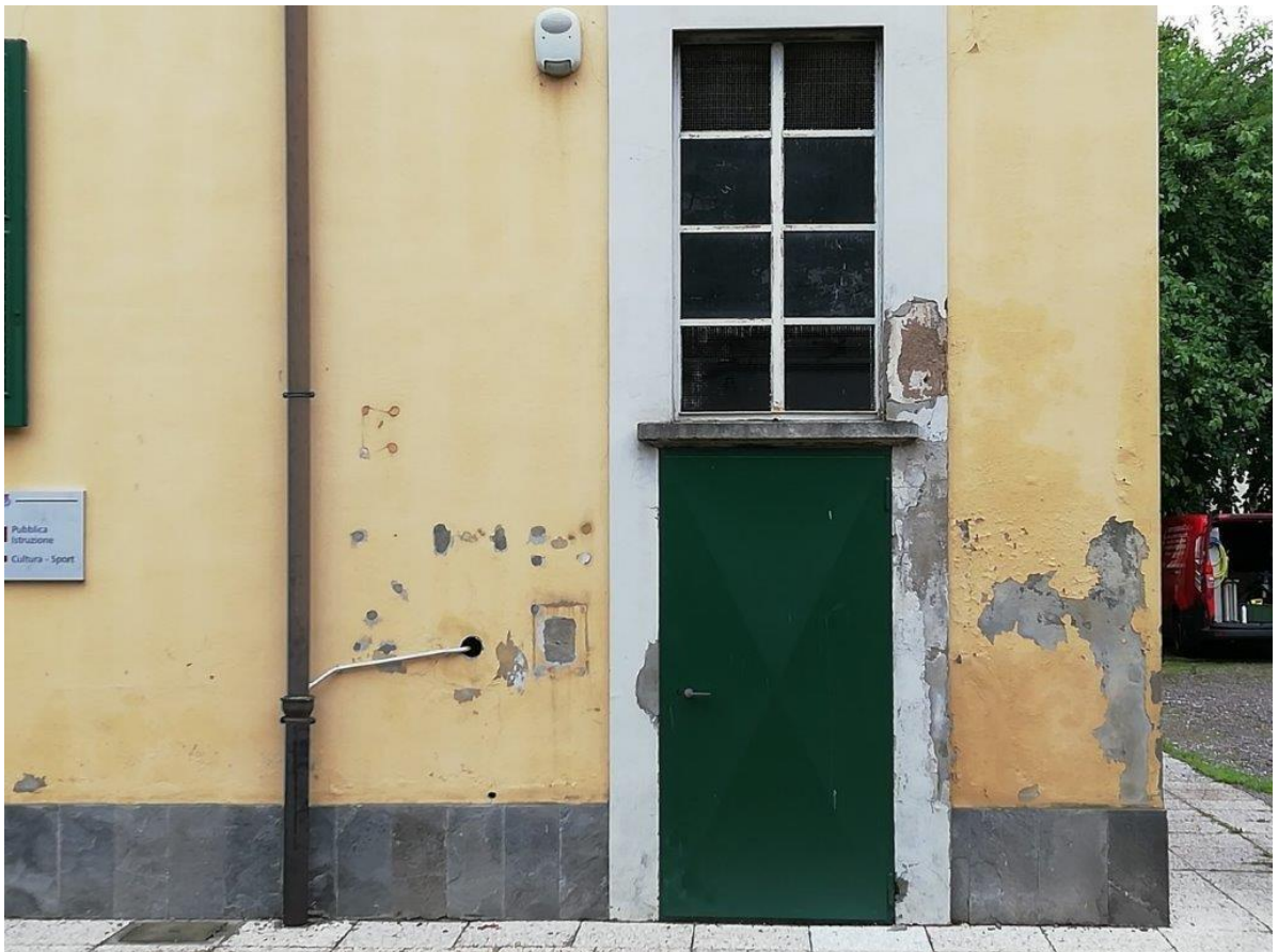
Porzioni di intonaco ammalorato da risalita di umidità
