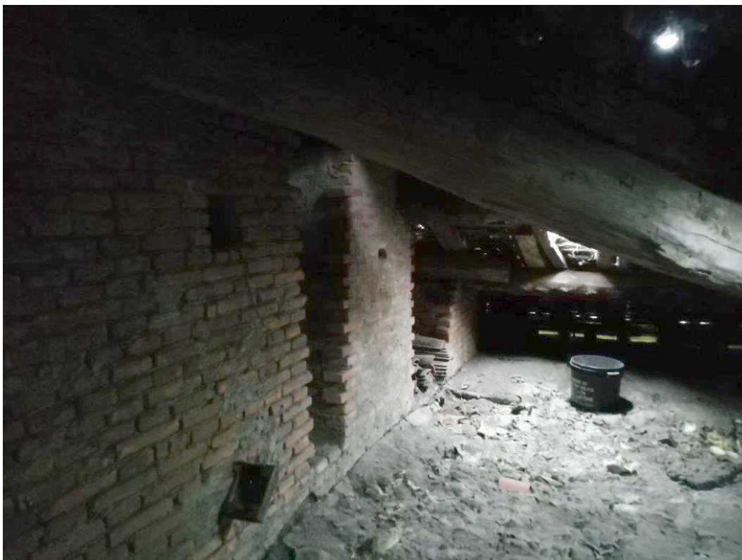
Strato coibente in lana di vetro da rimuovere e sostituire
