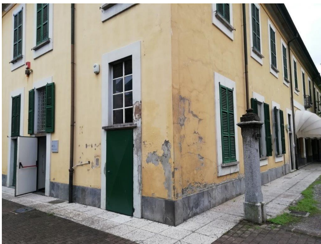
Intonaco ammalorato da risalita di umidità nell'angolo nord
