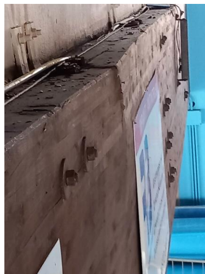
Particolare espulsione tasselli in legno piattabanda superiore
