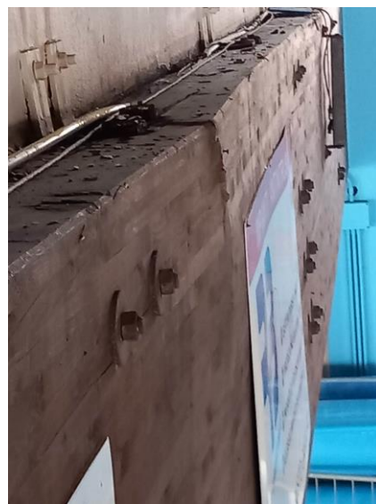
Particolare espulsione tasselli in legno piattabanda superiore
