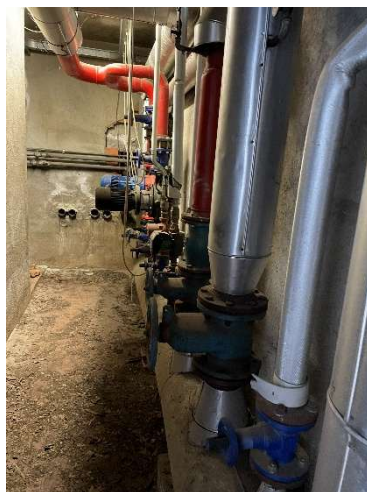
Collettore principale adiacente alla C.T.
