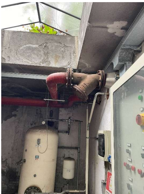
Quadro elettrico in centrale termica e bollitore ACS
