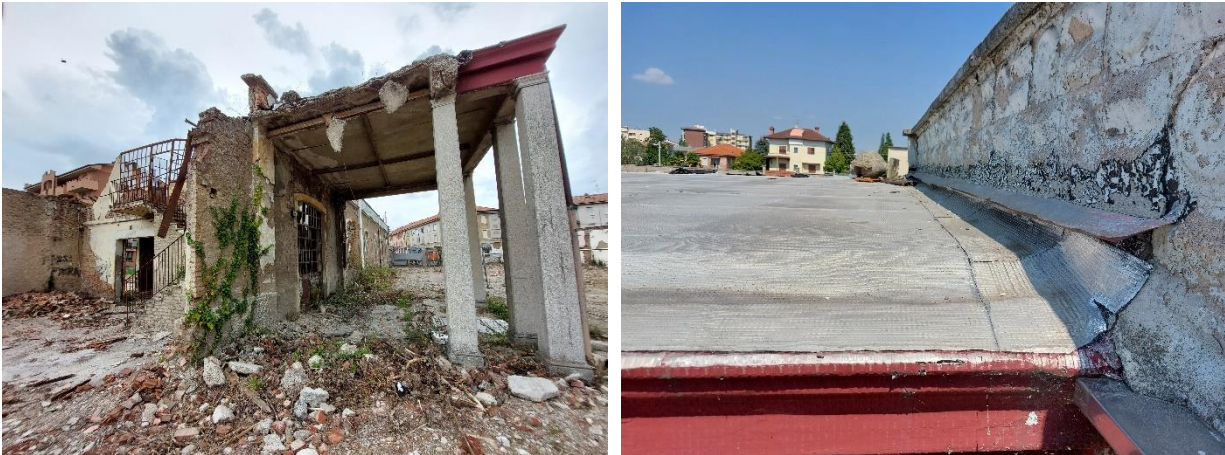
(A sinistra) la porzione di portico demolita, (a destra) particolare del collegamento della copertura con il fabbricato produttivo.
